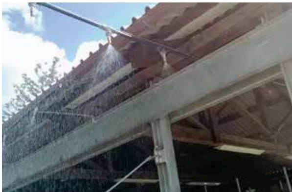
【写真5】 シャワー装置（パーラー戻り通路）
