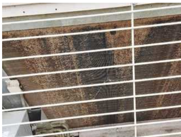
埃がたまった冷凍機のフィルター
