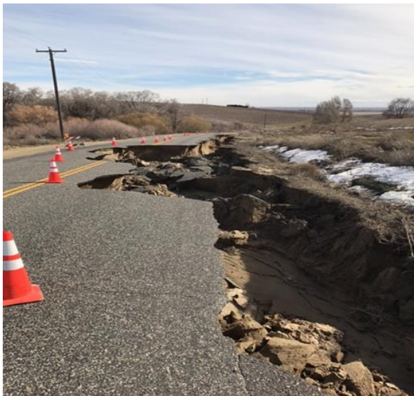
(ワシントン州南部 道路崩壊の状況)
